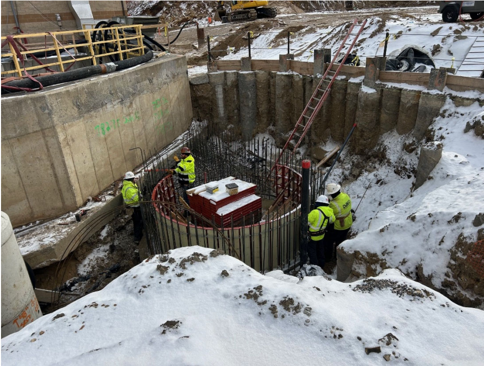
Vortex Grit Separator
